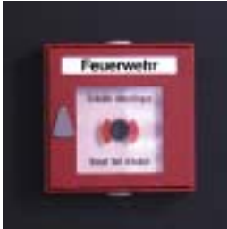
Druckknopfmelder im Gebäude
